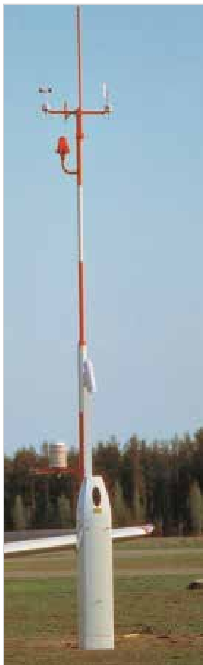
Obr. 4 Automatická letecká meteorologická stanice AW-11 pro stanoviště letecké záchanné služby v Plzni-Líních
