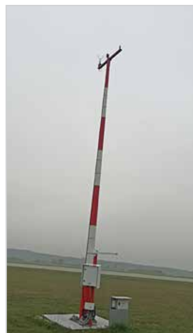
Obr. 15 Stožár křehké konstrukce na letecké základně s instalovaným ultrasonickým čidlem na měření směru a rychlosti přízemního větru v 10 m a pomocný stožár se senzory teploty, vlhkosti a tlaku
